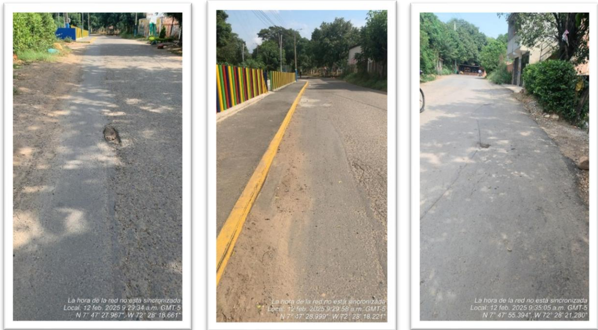
Fotografía No.26, 27, 28, 29, 30,31, Daños y fallos en la recuperación del pavimento.
