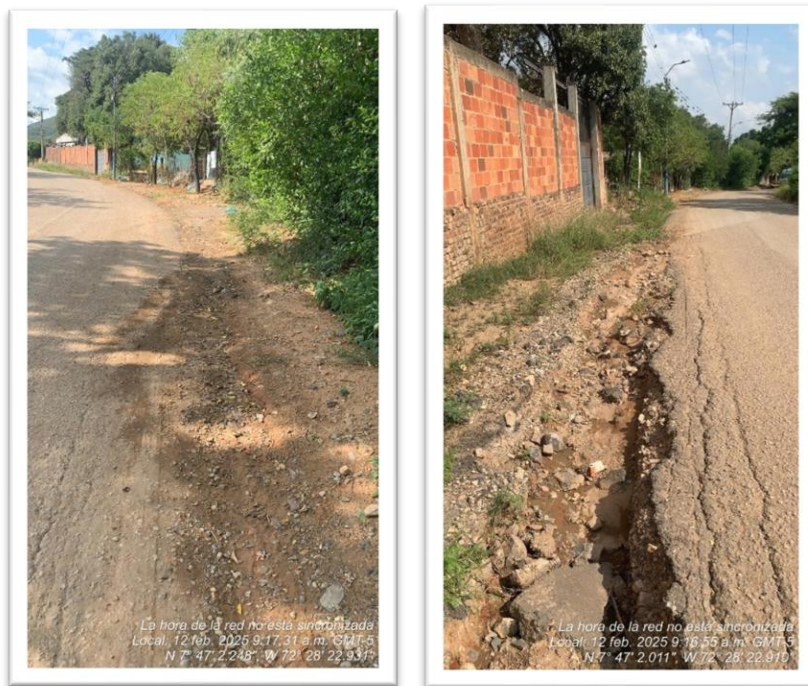
Fotografía No.32 y 33. Tramos sin recuperar pavimento
