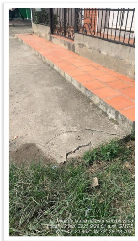
Fotografía No.24 Daño andén de vivienda, aún no ha sido reparado
