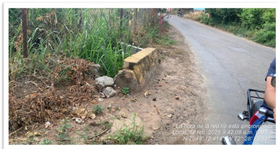
Fotografía No. 22 Aleta alcantarilla sin reparar, paso especial No. 7
