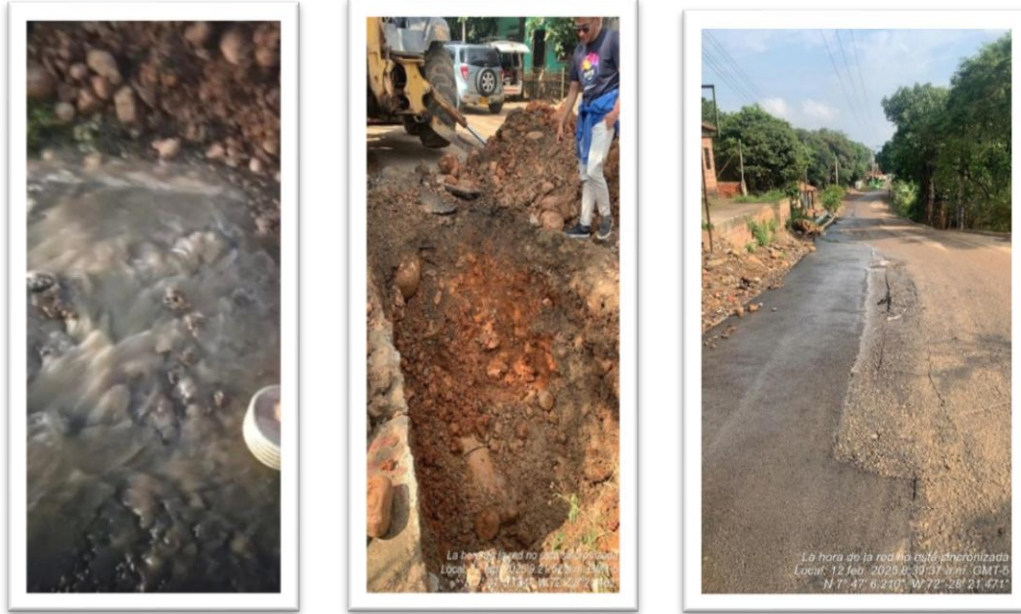
Fotografías N° 19,20 y 21 daño presentado en la línea de aducción antigua en Asbesto Cemento, y daño en el pavimento existente
