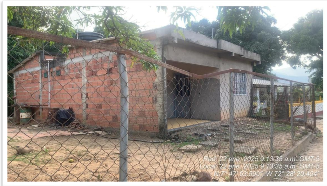
Fotografía No. 23- Cerramiento de lote El cerramiento del lote de la vivienda aún no se ha arreglado.
